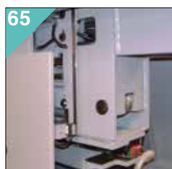
65 Ukazatel rychlosti posuvu pilového rámu
