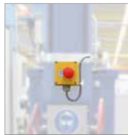
NOUZOVÝ VYPÍNAČ umístěn na pístu
