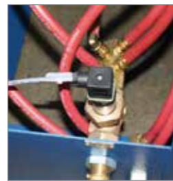
ČIDLO PRŮTOKU CHLADICÍ KAPALINY umístěno u přívodu vody
